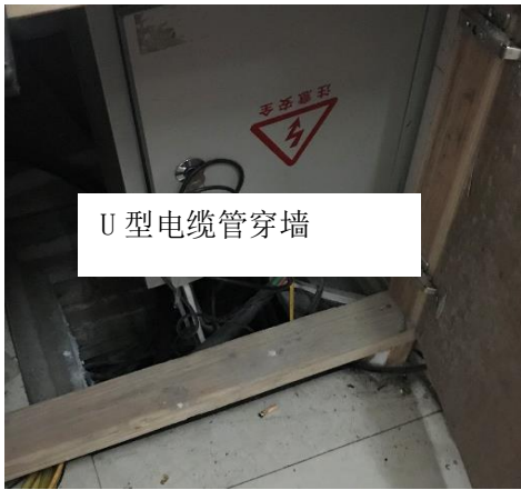
图 13 探伤房电缆设置
