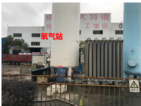
图 1 探伤房东侧氧气站
